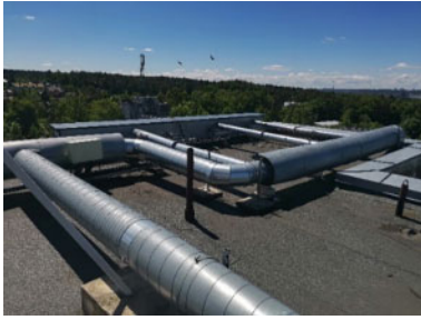
4 paveikslas. Nagrinėjamo neįstiklinto pratakaus saulės kolektoriaus oro surinkimo gaubtas (plenumas) su iš jo išeinančiais ortakiais
